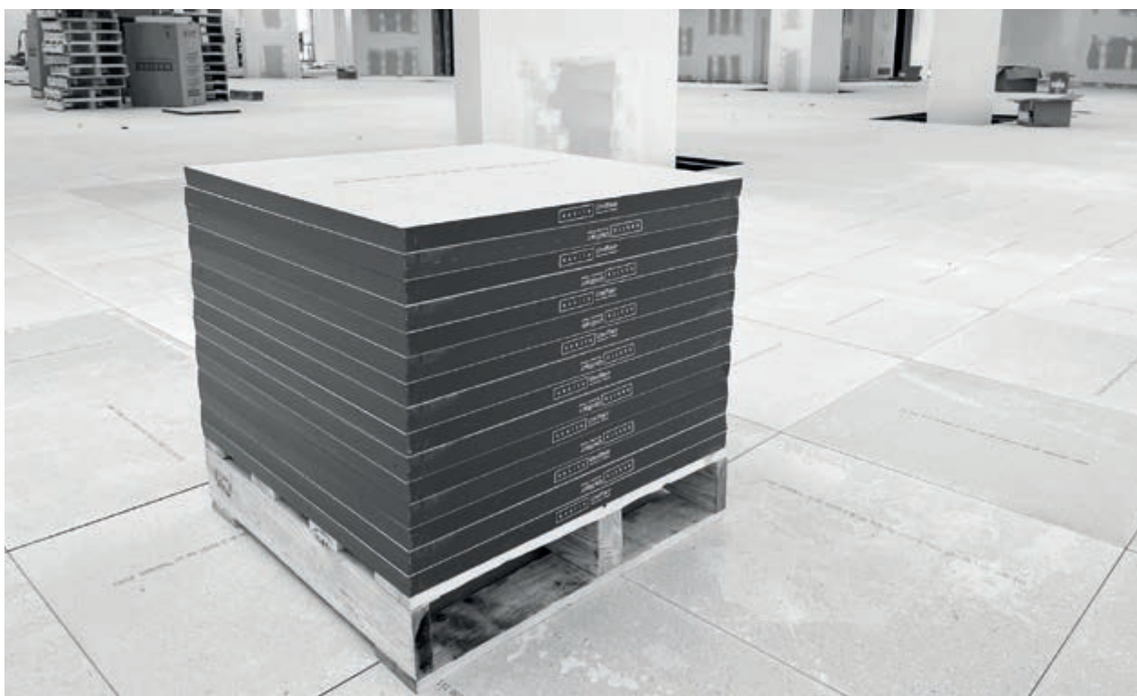
Condizioni di cantiere. Posizionare le confezioni dei componenti solo nei pressi della zona dell'installazione
